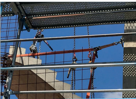
Positionieren von Lasten insbesondere bei Verwendung mehrsträngiger Kettengehänge (z. B. Einbau von Treppensegmenten und Turbinen)
